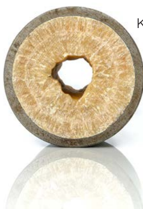
Kalkaflejring i drikkevandsrør
